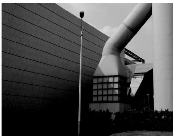
图 3-4 除尘设备机站治理后图片
